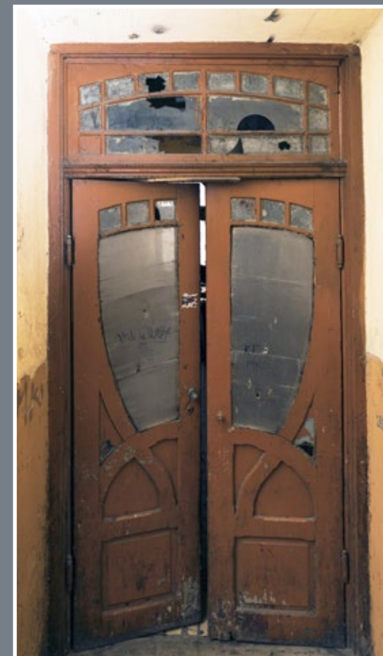
20 Drzwi z sieni do klatki schodowej w kamienicy przy ul. Kazimierza Wielkiego 15
