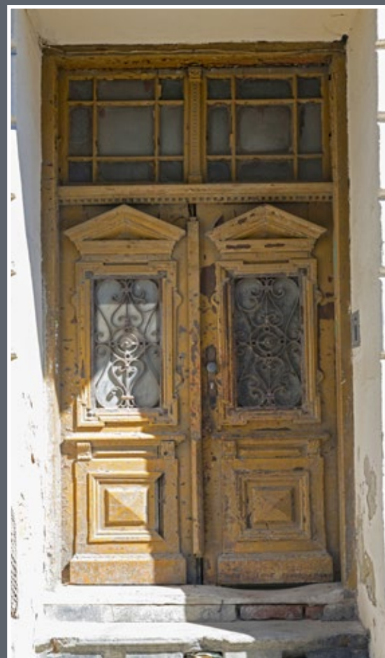
29 Drzwi w kamienicy przy ul. Słowackiego 19 z zachowanymi fragmentami oryginalnego grawerowanego szkła ornamentowego w nadświetlu
