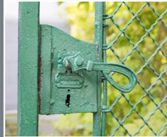
147 Ogrodzenie willi przy ul. Puszkina 19 z bramą wjazdową; słabo czytelna sygnatura wykonawcy (prawdopodobnie Władysława Wojnara) na bramce
