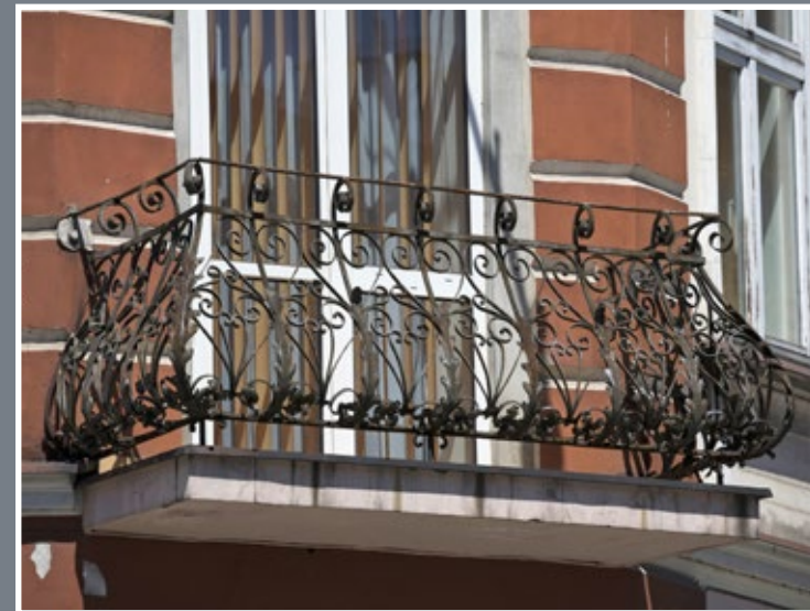
27 Balkon w kamienicy przy ul. Grunwaldzkiej 30 z segmentami dekoracji wolutowej dzielonymi motywem płaskiego liścia akantu
