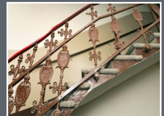
27 Balustrada schodów w kamienicy przy ul. Słowackiego 52 z odlewanymi w żelwie elementami w formie tarcz i grotów
