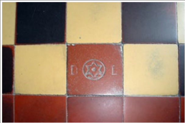
61 Płytki spocznika schodów w kamienicy przy ul. Grotgera 4 z sygnaturą „D-L” (firma Dziewulski i Lange)
