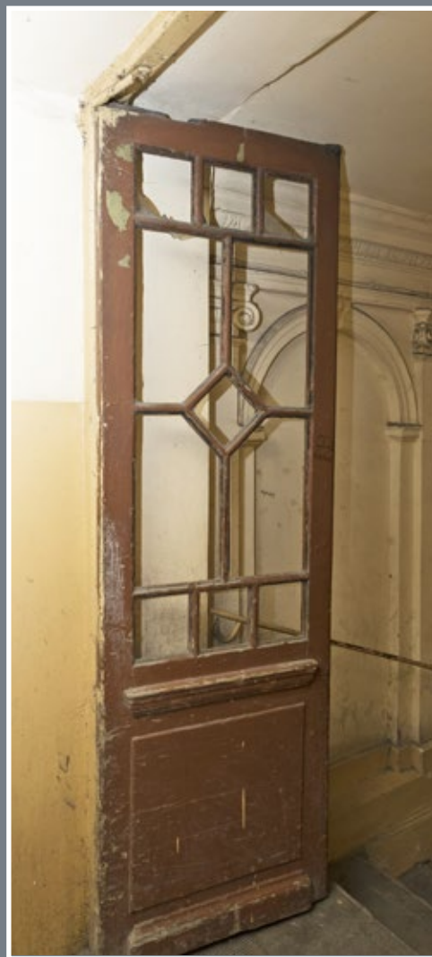
9 Skrzydło drzwi wewnętrznych prowadzących do klatki schodowej w kamienicy przy ul. Kazimierza Wielkiego 2/ Rynek 8
