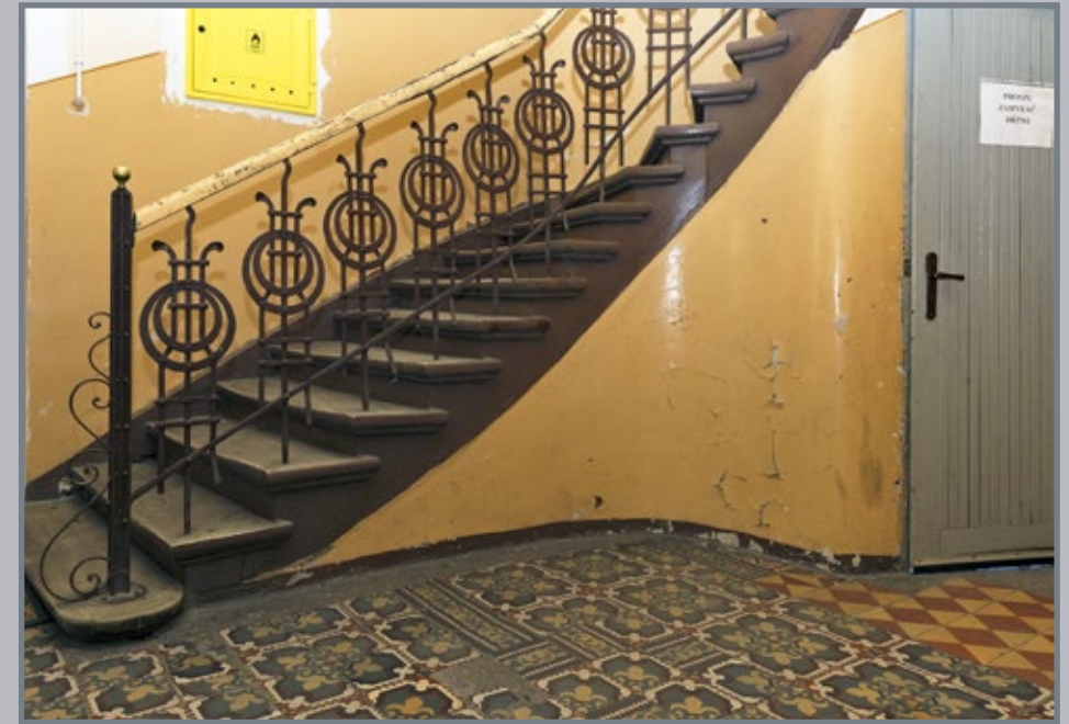
33 Balustrada schodów w kamienicy przy ul. Konarskiego 5 o typowo secesyjnym motywie zgeometryzowanego „pawiego oka”
