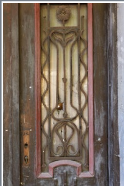
77 Krata prześwitu skrzydła drzwi wejściowych do kamienicy przy ul. Słowackiego 20 z delikatnie grawerowanych prętów zakończonych główkami węży
