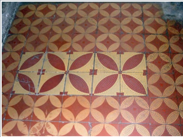
12 Posadzka na podeście schodów w kamienicy przy ul. Mickiewicza 11
