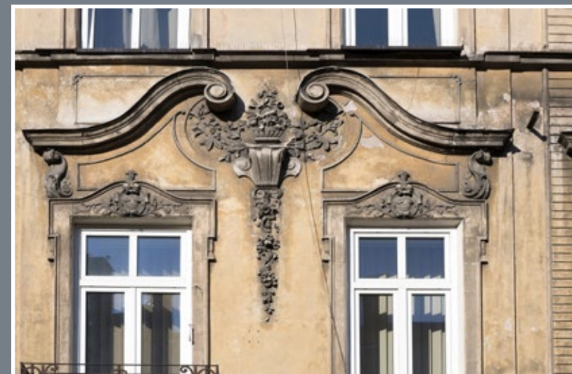
33 Detale wystroju elewacji kamienicy Henryka Herschdorfera z ok. 1908 roku przy ul. Franciszkańskiej 17
