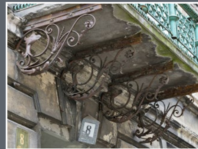
20 Balkon w kamienicy przy ul. Tarnawskiego 8; masywna balustrada z odlewanymi przęsłami jest połączona z lekkimi, kutymi wspornikami z motywem orlich głów
