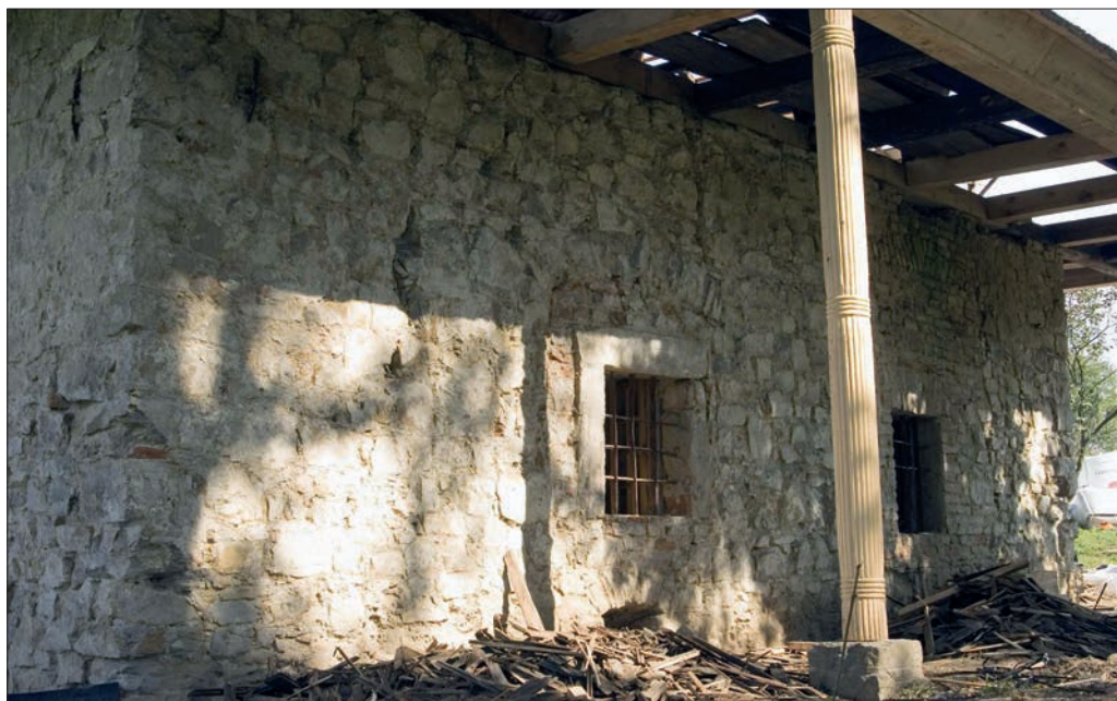
Il. 13. Lamus w Hawłowicach Górnych, elewacja południowa po skuciu tynków, stan z 2005 r. Widać wąż murów lamusa i osadzenie okien we wtórnych przymurówkach ceglanych; fot. J. Szyma.
