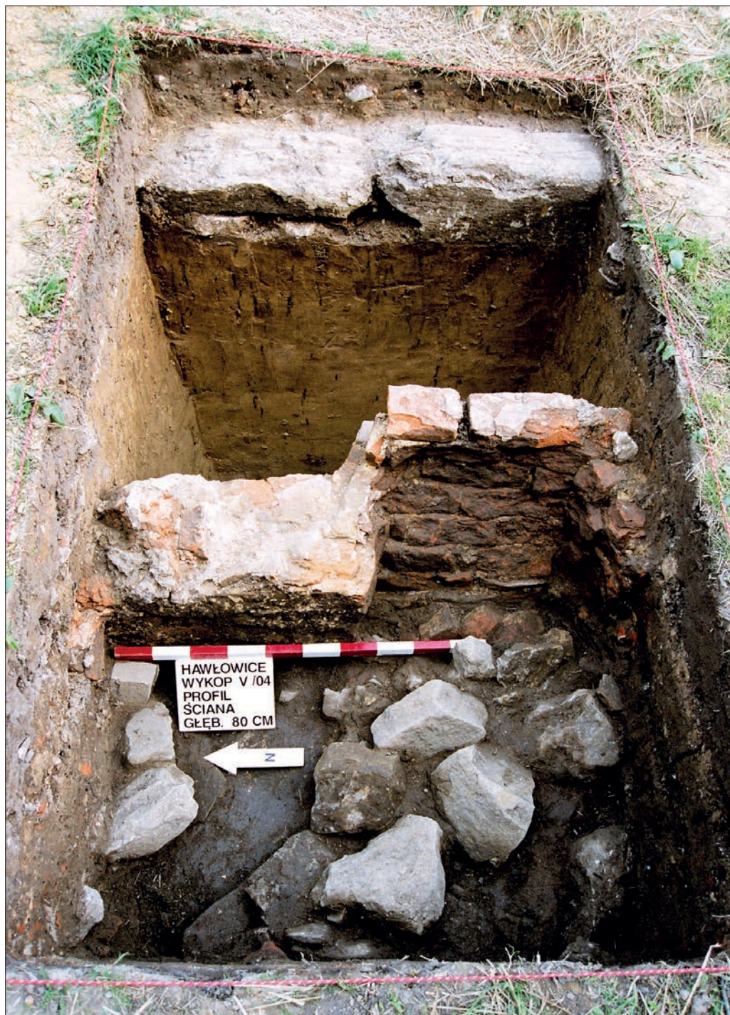
Il. 13. Ściana wschodnia komory piwnicy od wschodu z widocznym doświetlającym ją pierwotnie okienkiem.
