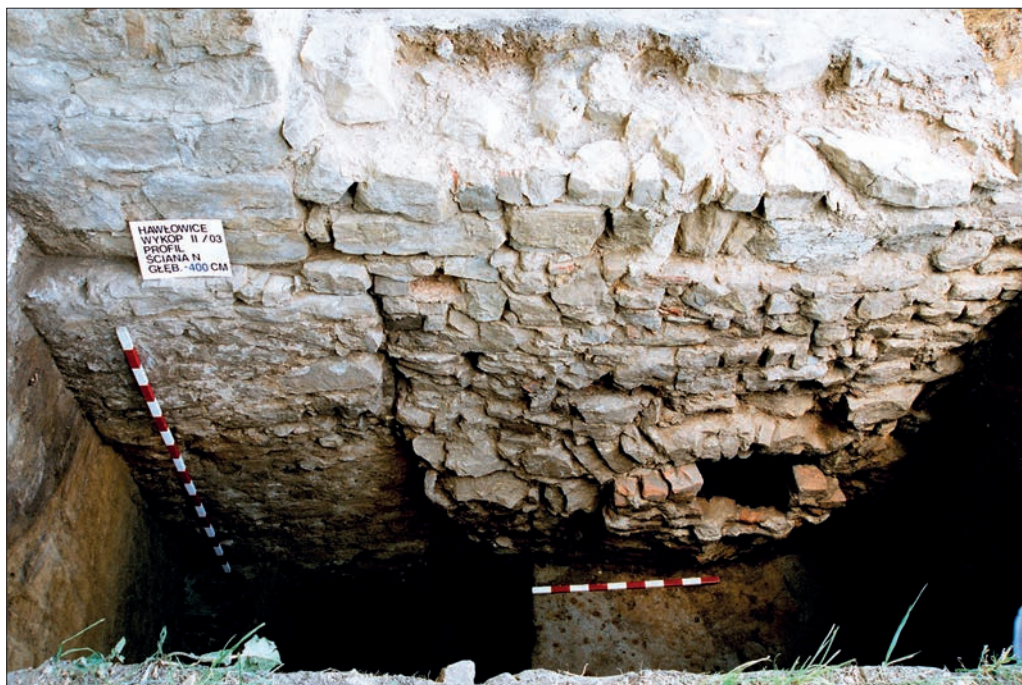
Il. 7. Wyraźna dylatacja pomiędzy fundamentem lamusa i fundamentem korytarza piwnicznego.
