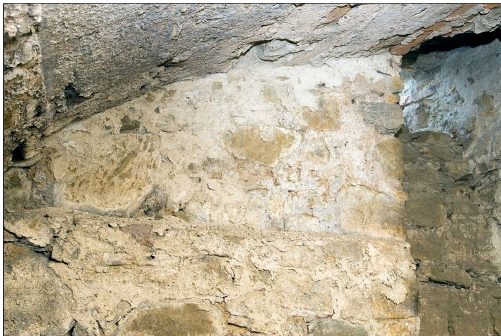
Il. 24. Lamus w Hawłowicach Górnych, zachodnia komora piwnicy, ściana zachodnia. Widoczny styk muru obwodowego piwnicy ze sklepieniem, poniżej odsadzka, po prawej szychta okna; fot. J. Szyma.
