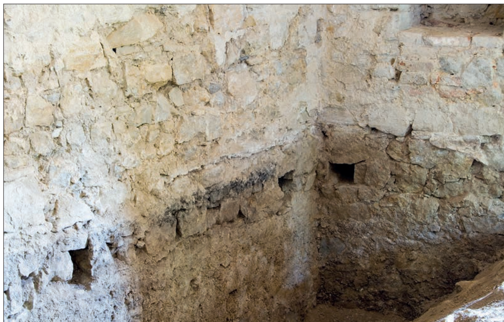
Il. 28. Lamus w Hawłowicach Górnych, narożnik północno-wschodni sali parteru po zerwaniu posadzki. W pasze sklepienia piwnicy widoczna odsadzka, wyżej gniazda belek; stan z 2005 r., fot. J. Szyna.
