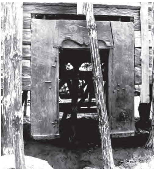
Struktura cerkwi w trakcie wymiany podwalin i dolnych belek konstrukcyjnych, pocz. lat 90. XX w. Fot. Archiwum WUOZ w Przemyślu
